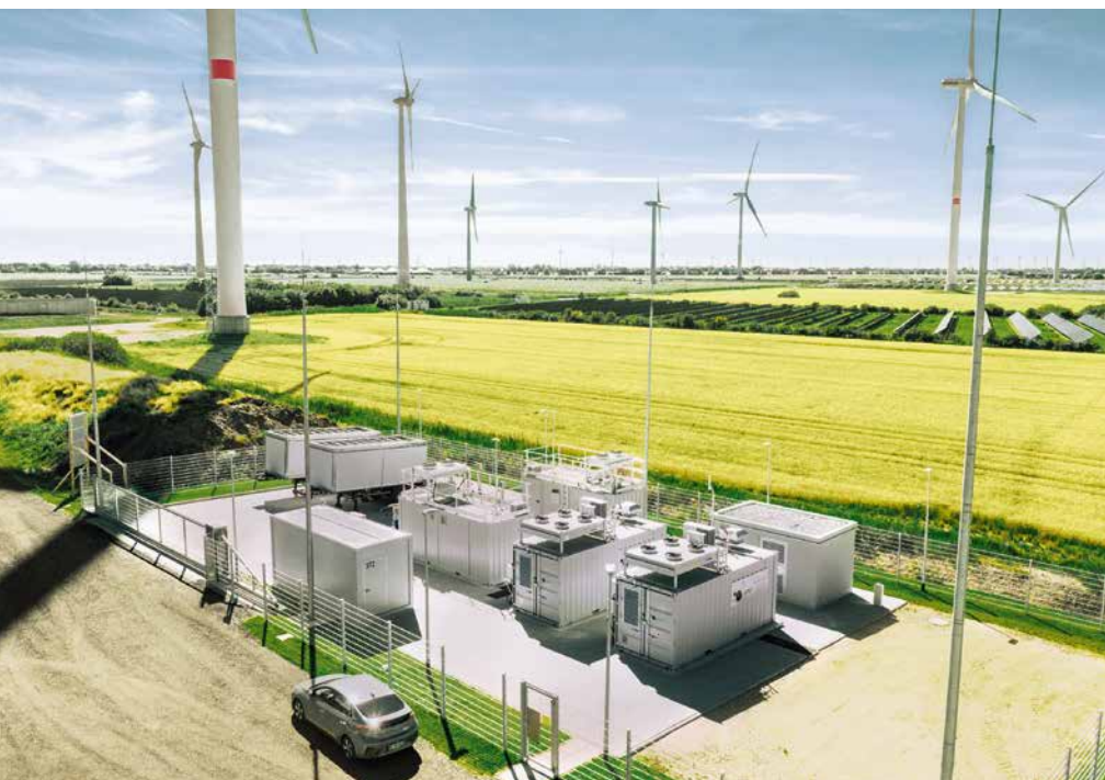
Abb. 1: Als Teil des eFarm-Projekts in Nordfriesland wandeln die PEM-Elektrolyseure von H-Tec Systems erneuerbaren Strom in grünen Wasserstoff um [Quelle: H-Tec Systems]
