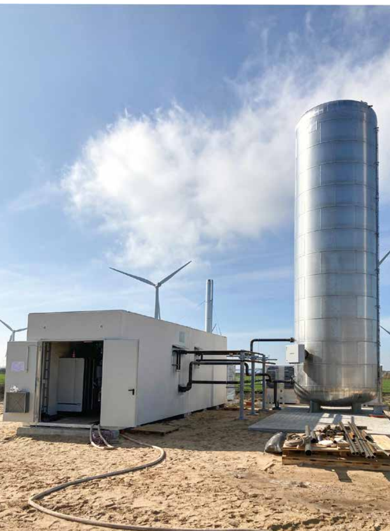
Abb. 2: Die Energiezentrale und der 14 Meter hohe Wärmespeicher [Quelle: YADOS GmbH]
